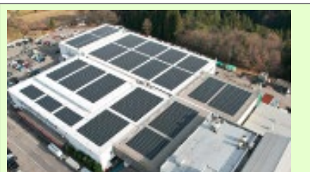
富山事業所 太陽光発電設備
