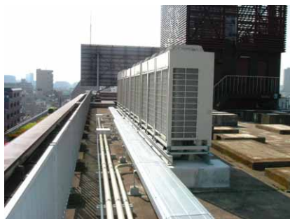
屋上に設置した室外機
