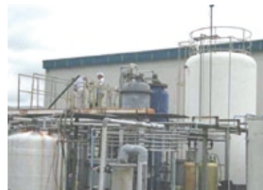
エッチング用純水システム
